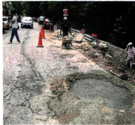
■公寓的出入口道路已有下陷情况。
