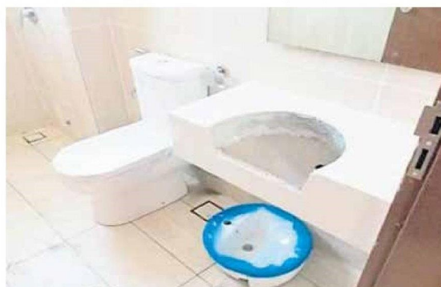
■ 砖脱落。包括浴室整个洗手盆掉落在地，但内部遭人入侵破坏，部分瓷
